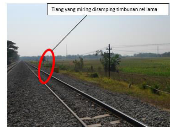
Gambar 1. Kemiringan Tiang Listrik
