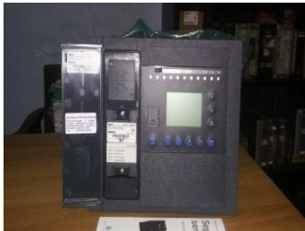
Gambar 11. Pemasangan Relay Proteksi dan Power Meter
