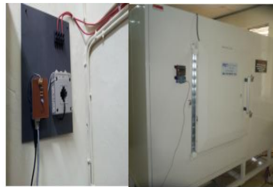
Gambar 9. Alat terpasang pada Anechoic Chamber Laboratorium Antena dan Propagasi
