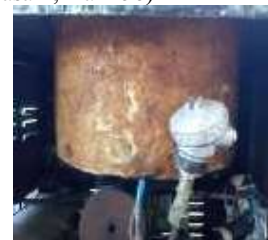
Gambar 2.4 evaporator ( Lab.Refrigerasi Politeknik Sekayu )
