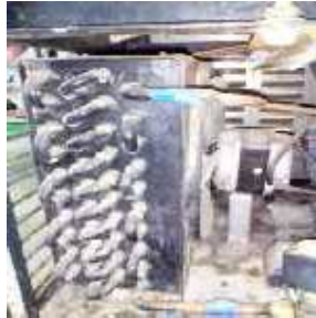
Gambar 2.5 kondensor ( Lab.Refrigerasi Politeknik Sekayu )
