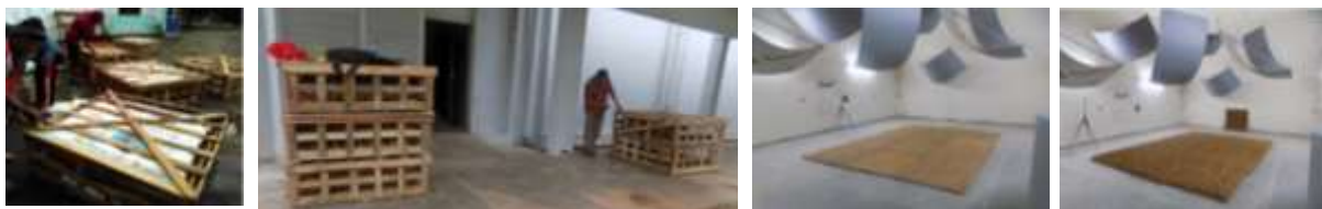
PANEL BUNU DI LABORATORIUM AKUSTIK LIPI SERPONG
