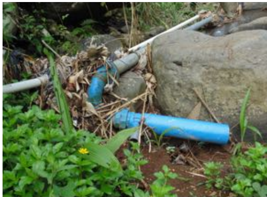
Gambar 4. Kondisi instalasi pompa hidram yang rusak akibat luapan air sungai.
