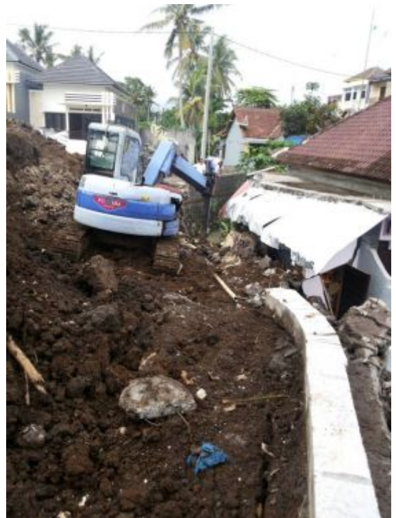
Gambar 2. DPT setelah runtuh
