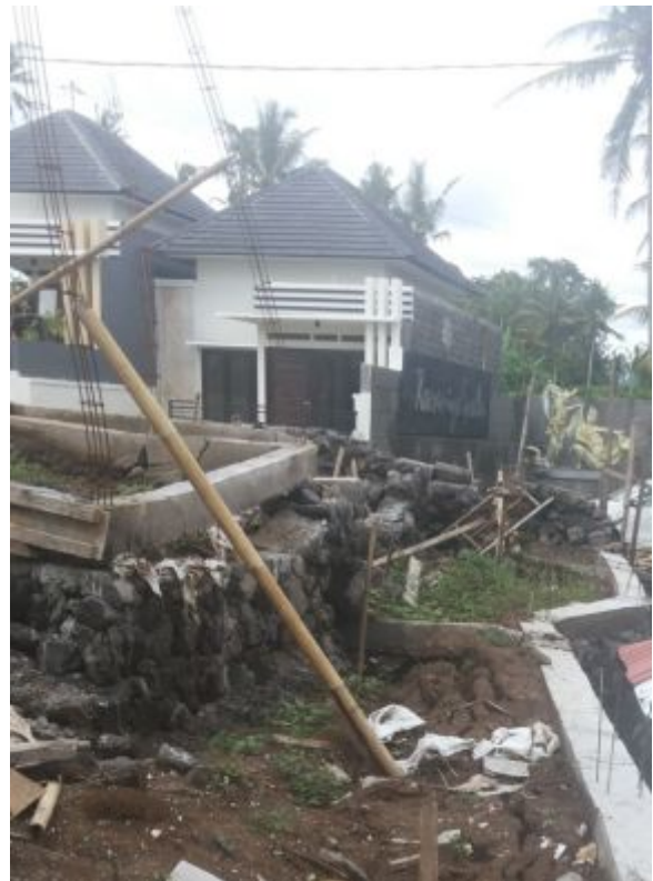
Gambar 4. Penurunan tanah akibat pergerakan DPT sebelum runtuh
