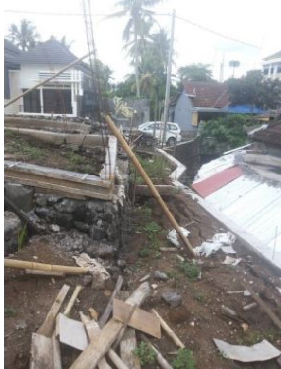
Gambar 1. DPT sebelum runtuh
