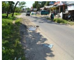
Gambar 3 Retak dan Penurunan badan Jalan
